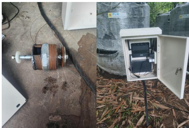
Gambar 2 Valve Hidram dan Box Panel /Listrik
